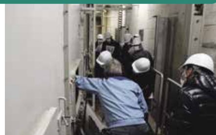
取水工内部（トラベリングスクリーン）
