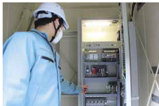
通信機器の点検
