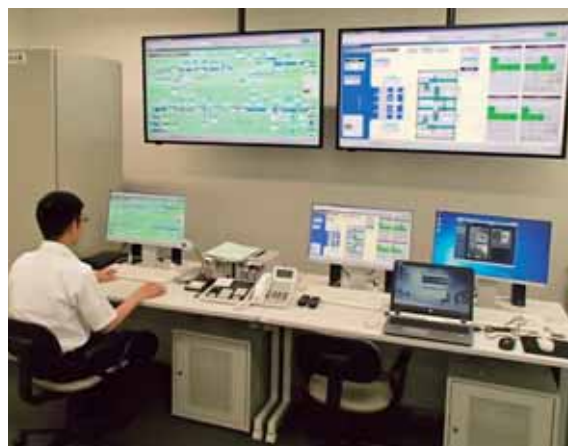
新中央管理所：テレメータ室
