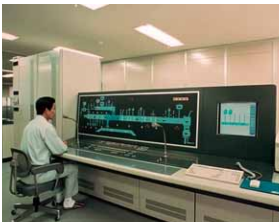
旧中央管理所：テレメータ室
