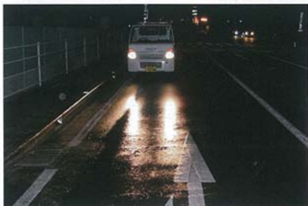
埋設管からの漏水
